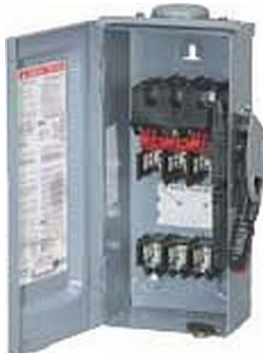
Figura 9.7- Centro de distribución de carga
